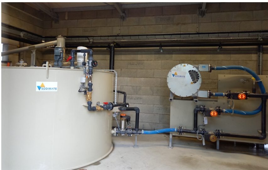
Groupe de préparation de lait de chaux et skid de pompe péristaltique à l'intérieur du bâtiment
